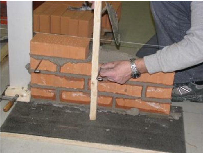
Foto 3. Ved bund og top indsættes 1 binder pr sten i 3. skifte fra bund og top. For den viste væg er dette 3 bindere i de aktuelle skifter
