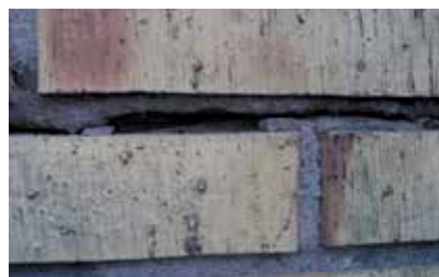
Korroderande armering spränger och trycker ut murverksfogen.
